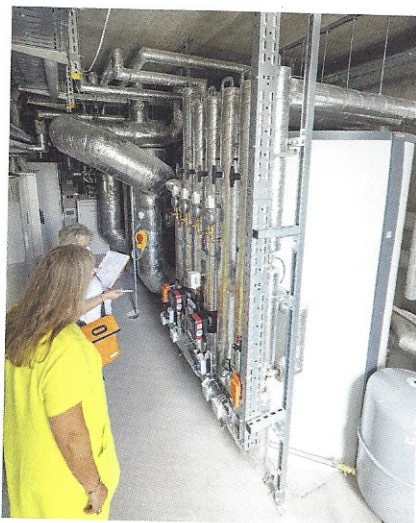
Blick in die Technikzentrale des Quartiers. Foto: Hans-Wilhelm Berghoff
